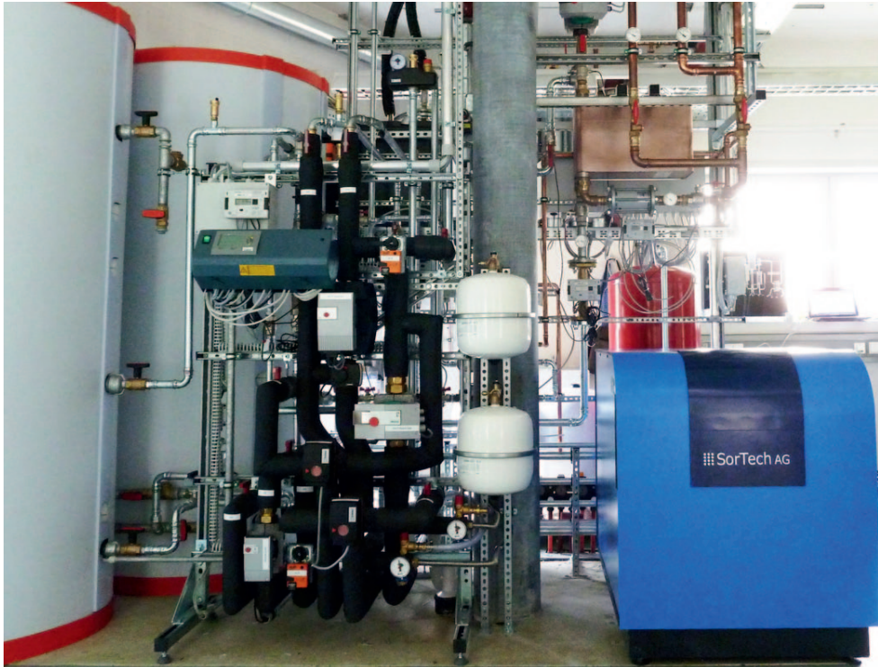
Anlage zur solaren Kühlung an der Richard-Fehrenbach-Gewerbeschule in Freiburg. Eingebaut wurde dort eine Adsorptionskälteanlage, die mit solarer Wärme betrieben wird.
