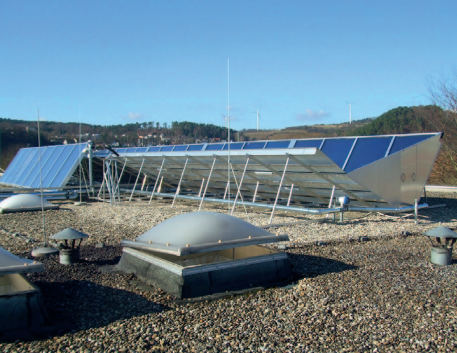
Wäscherei Laguna in Marburg (Lahn) mit Prozesswärme-Flachkollektoren.
