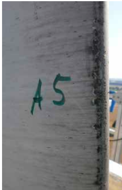
Inspektion einer durch Regen erodierten Rotorblattoberfläche
