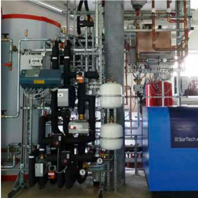
Anlage zur solaren Kühlung an der Richard-Fehrenbach-Gewerbeschule in Freiburg. Eingebaut wurde dort eine Adsorptionskälteanlage, die mit solarer Wärme betrieben wird.
