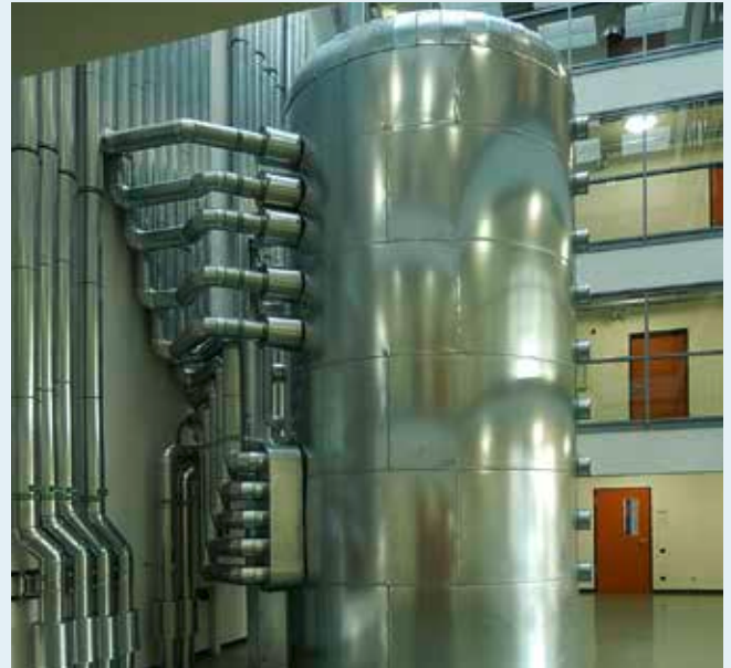
Wärmespeicher im Eingangsbereich des Energiezentrums der BTU Cottbus.
