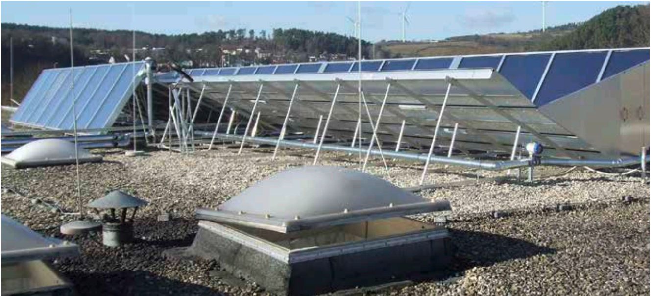
Wäscherei Laguna in Marburg (Lahn) mit Prozesswärme-Flachkollektoren.
