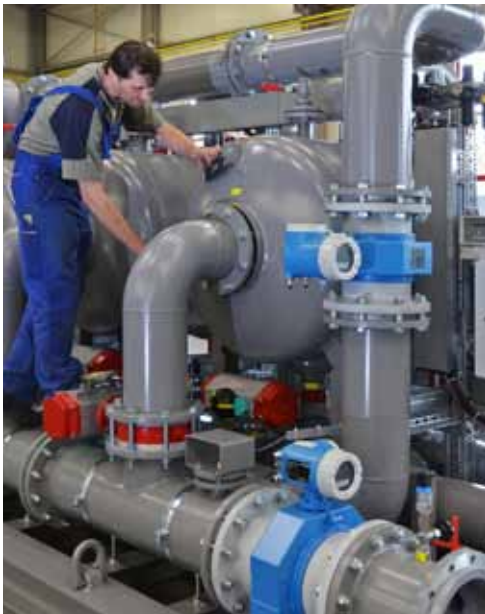
Das System zur Behandlung von Ballastwasser ist bereit für den Einsatz an Bord.
