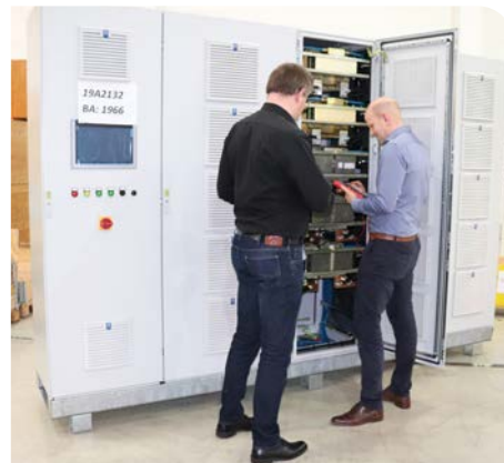
Überprüfung der wassergekühlten Drosseln an einem der vier 3-MVA-Frequenzumrichter des Gesamtprüfstandes
