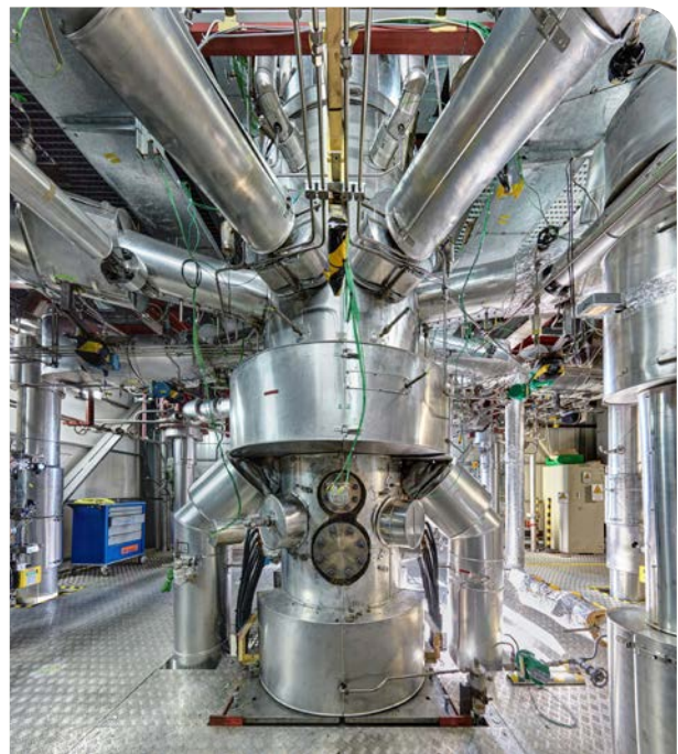
Reaktordruckbehälter der Primärkreislauf-(PKL-)Versuchsanlage mit Hauptkühlmittelleitungen der Framatome GmbH
