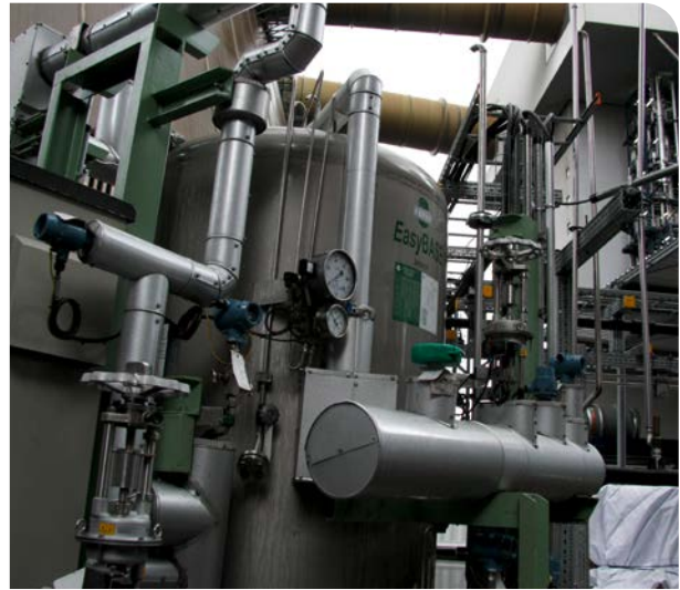
In dieser Anlage wird das als Flüssigkeit gespeicherte Kohlendioxid zu Gas verdampft.
