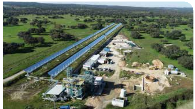
Luftaufnahme der HPS2-Forschungsanlage: Parabolrinnenspiegel (links oben), bedachter Drainage-Speicher (links unten), Stahlbau mit Speichertanks und Dampferzeugersystem (unten), Büro und Leitwarte-Container (Mitte).
